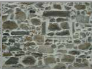
Joint plein au mortier de chaux trop blanc, à éviter
