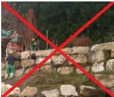
Enrochement de type cyclopéen interdit
